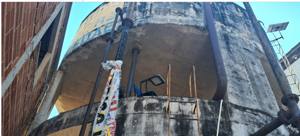
Foto 13 – Falta de guarda corpo e pintura (sem manutenção)
