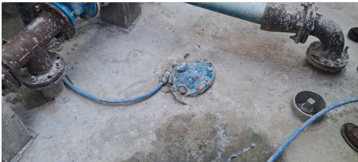
Foto 9 – Válvula controladora de nível enterrada
