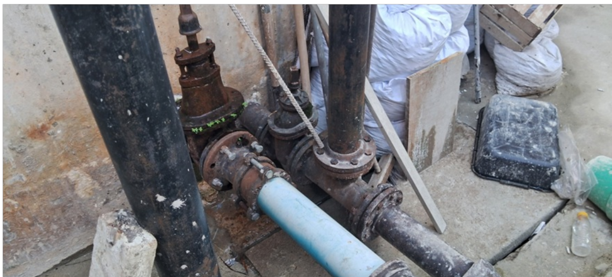
Foto 16 - Lixo encontrado no reservatório
