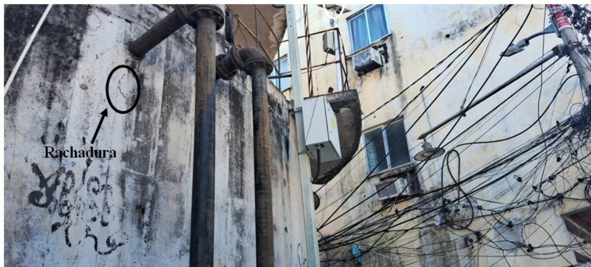
Foto 11 – Rachadura na primeira célula
