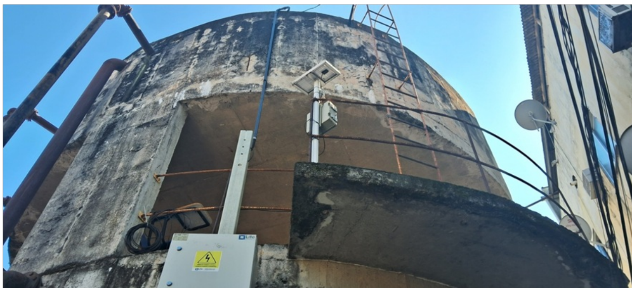
Foto 4 – Escada que liga a primeira célula a segunda, sem proteção
