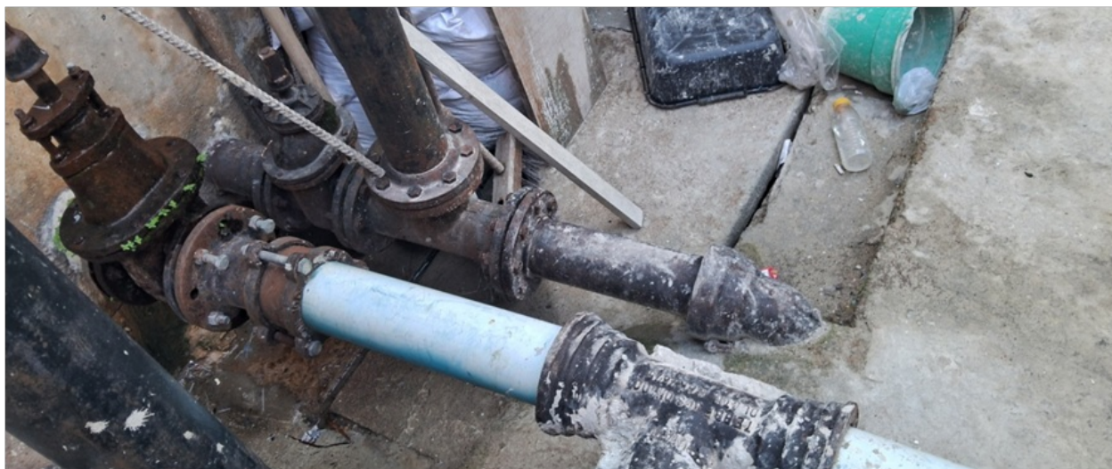
Foto 7 – Tubulação de limpeza e distribuidora
