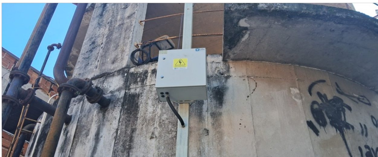
Foto 5 – Tubulações de recalque, extravasora e distribuidora
