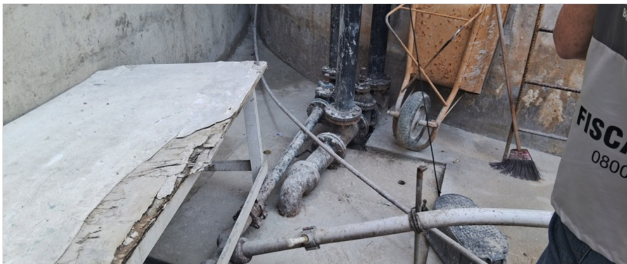
Foto 6 – Tubulação de extravasora e distribuidora
